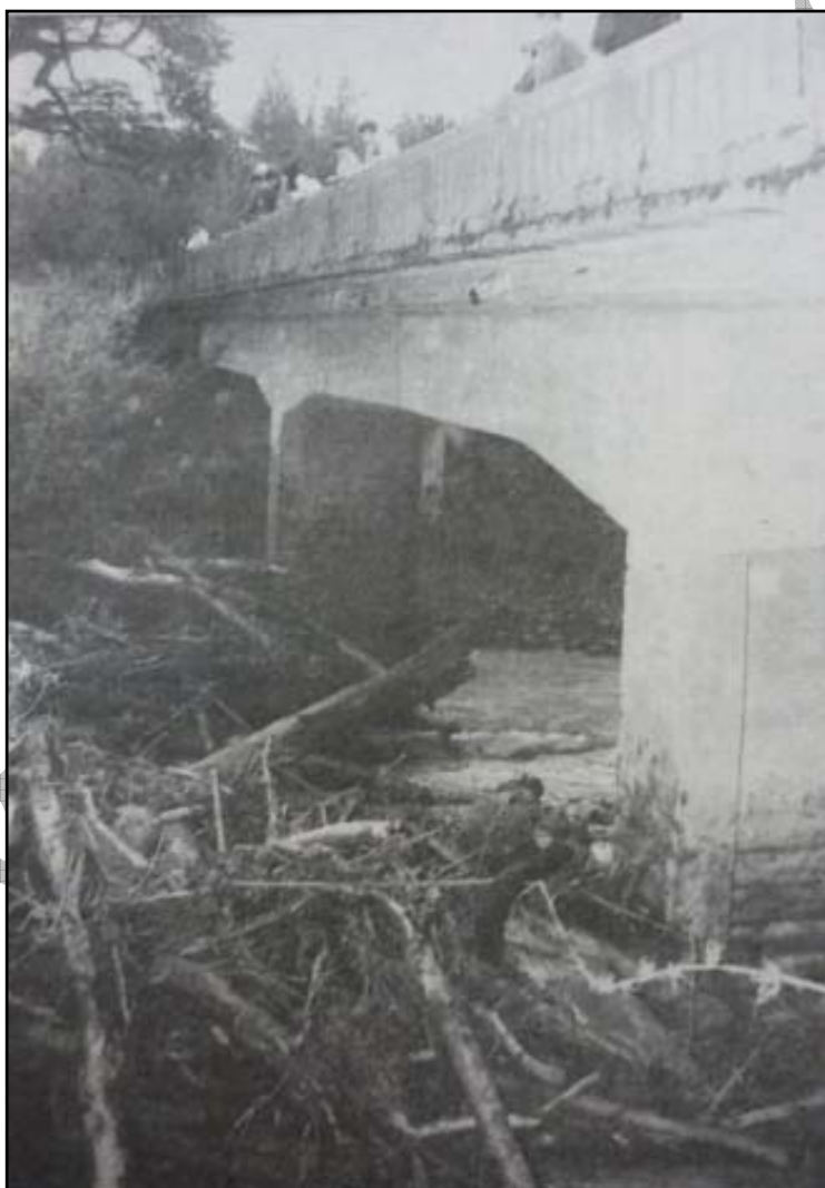
Troncos de árboles arrasados por la fuerza del aluvión, permanecían bajo el puente Quepe, a dos kilómetros al sur de Cherquenco, luego de retirarse la crecida.
